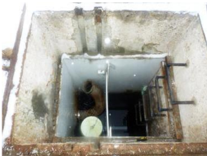
Obr. 7 Pohled do regulační šachty s osazenou magnetickou zpětnou klapkou a kruhovým plovákem
