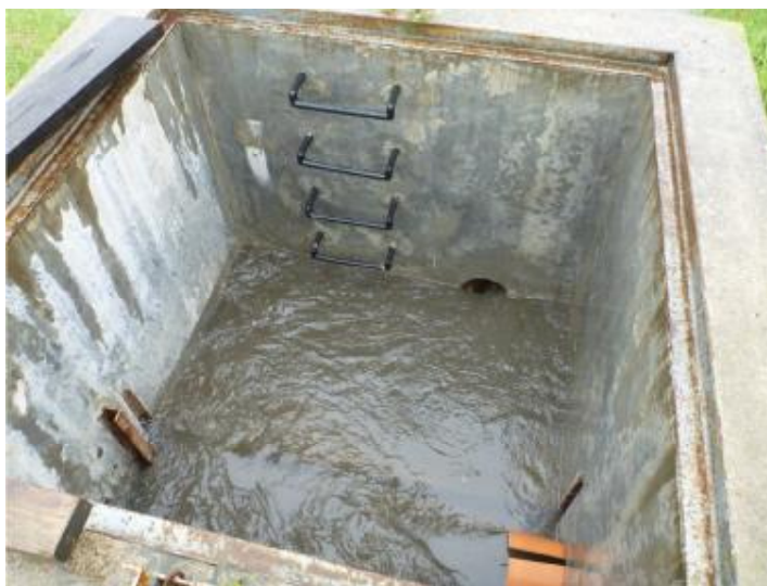
Obr. 2 Pohled na nefungující zatopenou odlehčovací komoru v původním stavu
