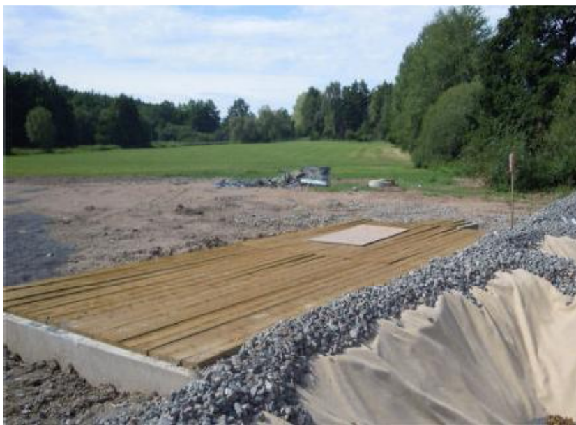
Obr. 3. Štěrbinová nádrž – KČOV Kotečnice.
