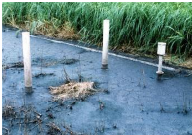
Obr. 1 Silně zakolmatovaná vtoková část filtračního pole vegetační kořenové čistírny
