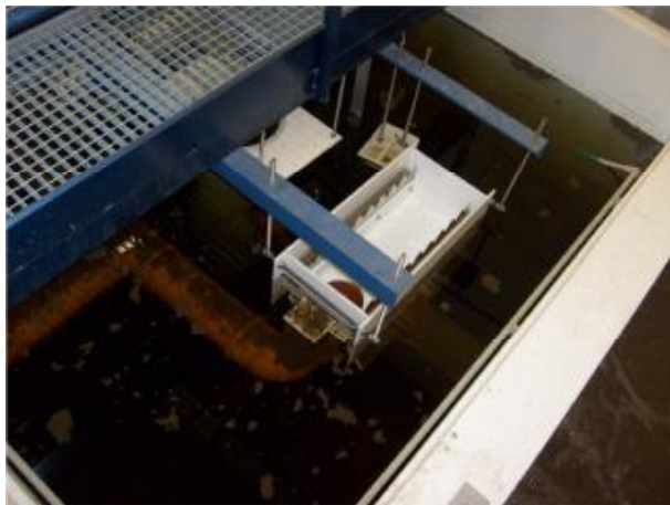
Obr. 1 Vestavěné dosazovací nádrže
